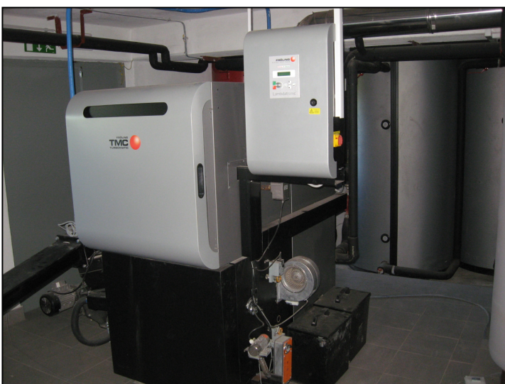
Kotlovnica proizvajalca Fröling.
